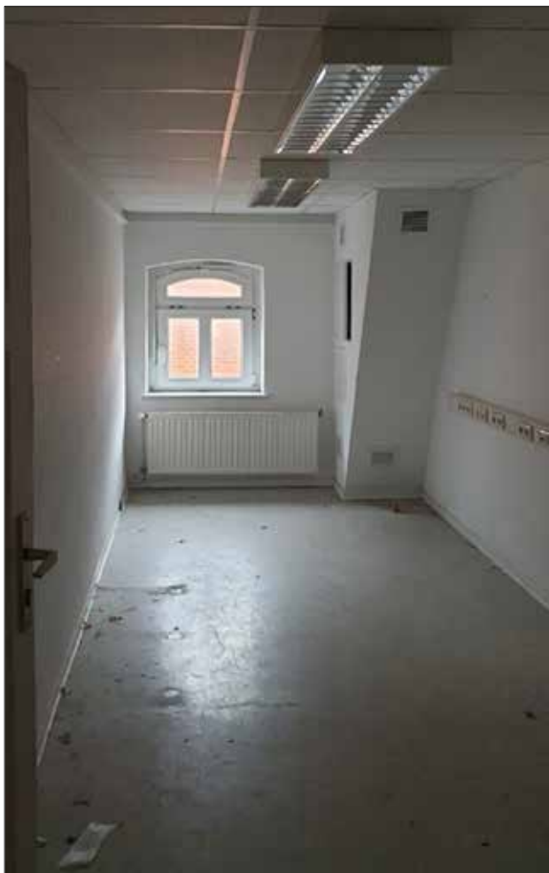
Abb. 30 Greifswald, Rotgerberstraße 8 (ehemaliges Gasthaus „Zur grünen Linde“), Vorderhaus, zweites Obergeschoss. Die kleinen Studentenzimmer im hinteren Teil waren etwa 17 m 2 groß. Foto: T. Klinko (2023)
